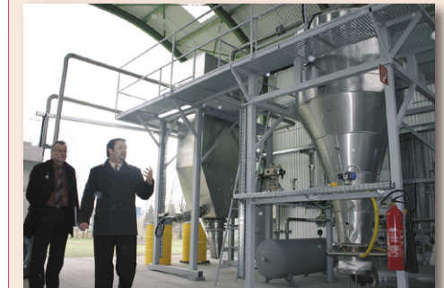
Marcel Huber von SynCraft erklärt die Funktionsweise der Technikumsanlage zur Biomasseverstromung.
